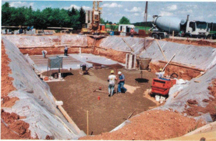
Die „erste“ Bodenplatte wird betoniert. Durch einen Fehler an Bauplänen mußte diese teilweise versetzt und erneuert werden.
