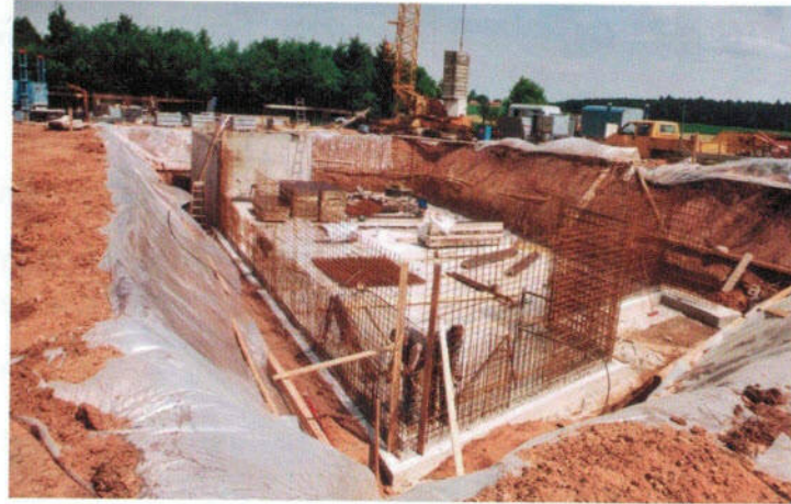
Erste Armierungen werden gesetzt. Nachdem der Fehler bemerkt wurde, war vorübergehend „Baustopp“.
